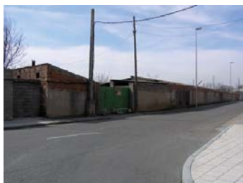
Edificios con un grado muy alto de deterioro en la zona de las viejas naves industriales.
