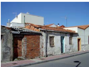
Ejemplos del deterioro de buena parte de las casas molineras del barrio.
