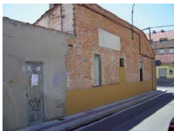
Vivienda unifamiliar en mal estado de conservación.
