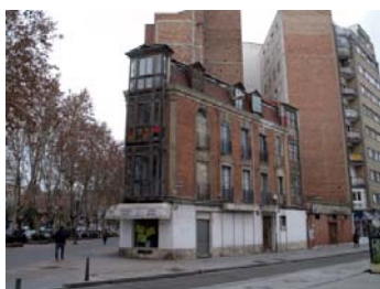
Edificio con un alto deterioro en la esquina entre el Paseo de Zorrilla y la calle de Magallanes.
