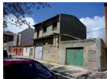
Viviendas en mal estado en la calle Pajarillos.
