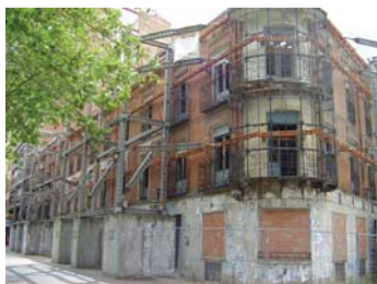
Antiguo hostel muy deteriorado en la confluencia del paseo de Zorrilla y la calle Puente Colgante.
